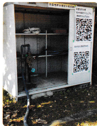
耐震性貯水槽給水栓
